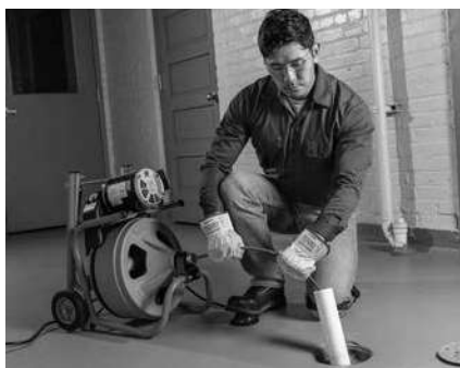
Figura 10 – Exemplu de prelungire a canalului de scurgere la distanță de 2' (0,6 m) de ieșirea cablului
